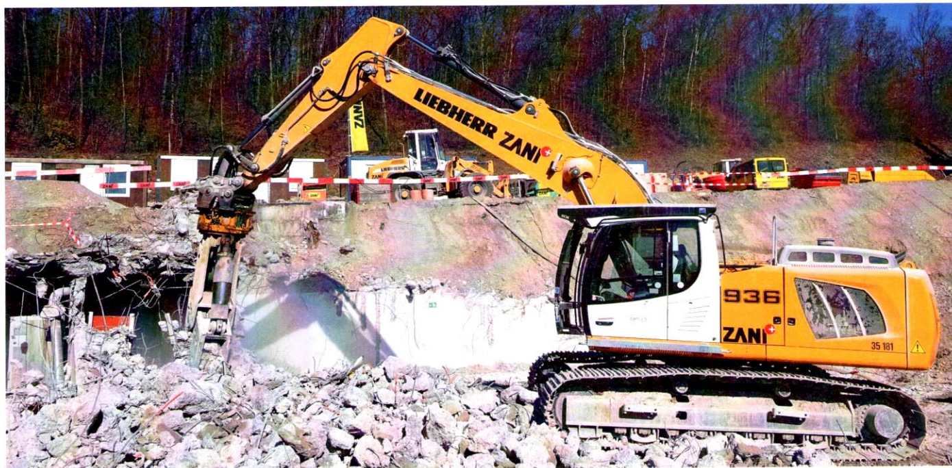
Der R 936 im Einsatz beim Rückbau auf der Baustelle «The Circle» beim Flughafen Zürich. Fotos: pd
